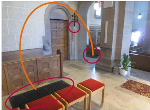
Abbildung 17: Möglicher Konzipierungsfehler des Luftauslasses (links) und Luftabzugs (rechts) in der Pfarrkirche St. Jakobus in Karlsdorf
