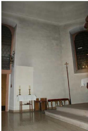
Abbildung 15: Vergrauung der Wände in der Pfarrkirche St. Jakobus in Weinheim-Hohensachsen
